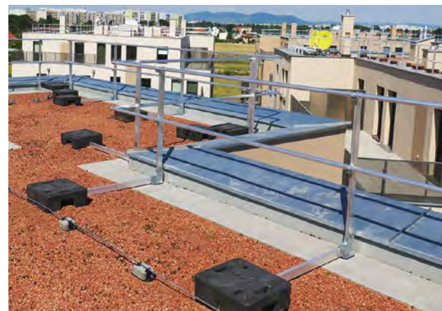
Sicherheitsgeländer selbsttragend Standard als Dachrandsicherung
